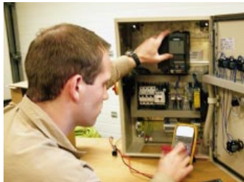
Schakelkasten worden in de eigen werkplaats gebouwd en getest.
